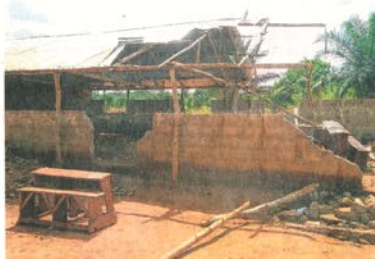
Bild der Zerstörung: Ein Teil der Schule in Sahé kann nach einem Sturm nicht mehr genutzt werden. FOTO: BÜRGERKOMITEE
